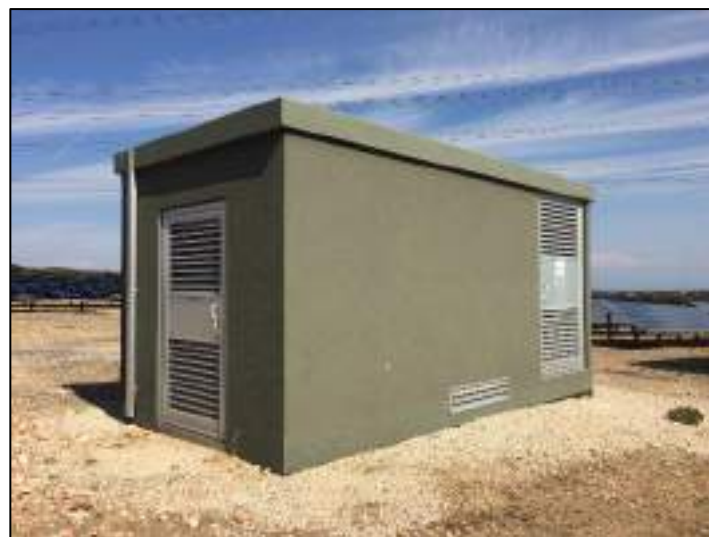
Exemple de poste de conversion « indoor »
