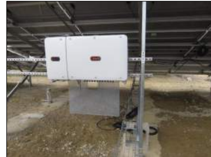
Exemple d'onduleur décentralisé
