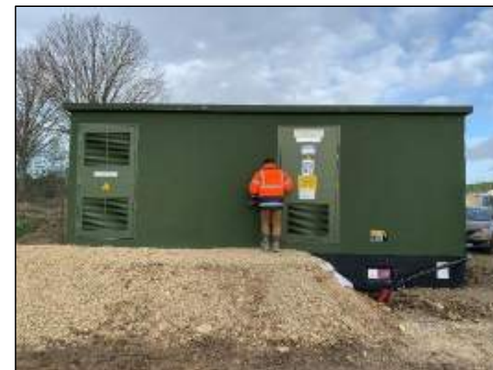
Exemple de poste de livraison
